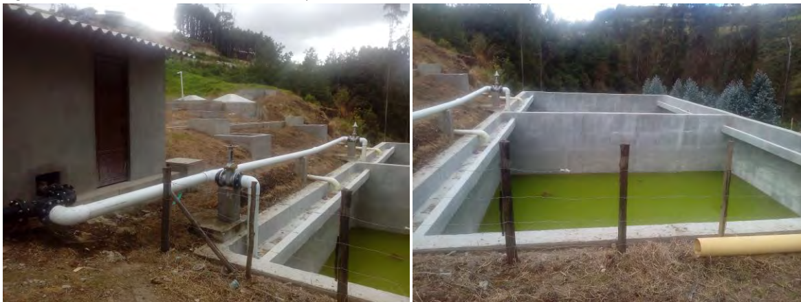
Figura 20. PTL de Recirculación Actual (Proceso de puesta en marcha)
